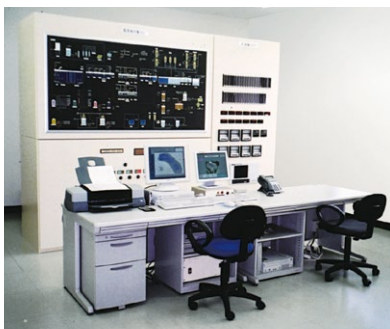
中央監視装置
