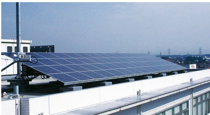
太陽光発電システム連係受電システム
